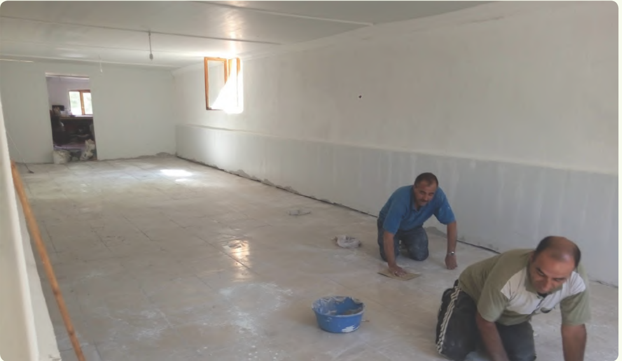
Mutfak Tadilatı Yapıldıktan sonra (Duvarlar yenilenip, elektrik tesisatı döşendi, fayans işlemleri gerçekleştirildi.)
